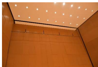
反響板内 昇降ボタン
